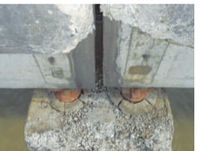
下部工の損傷
