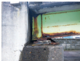
鋸桁の腐食状況
